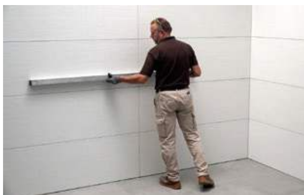
14. La parete si presenta perfettamente planare. 14. The wall is perfectly level. 14. Le mur est parfaitement plat. 14. Die Wand ist vollkommen eben. 14. Стена идеально ровная.
